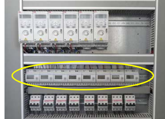
8 Μετρητές ηλεκτρικής ενέργειας
